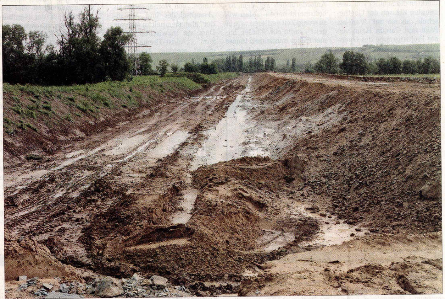
Ein Blick auf die Baustelle des Deiches, der bis Mai 2008 fertiggestellt sein soll. Der helle Strich in der Mitte zeigt eine frisch gegossene Dichtwand aus Beton, die zehn Meter tief ins Erdreich reicht. ■ Foto: Thao Vu Minh
